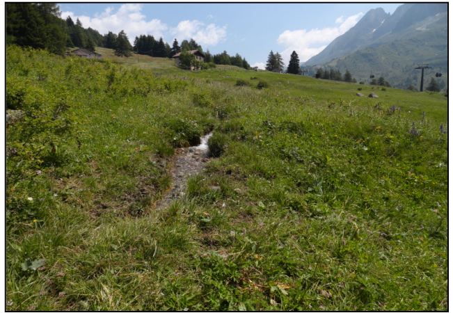
Acqua che può tracimare dall'alveo inesistente della valle laterale dx del Lares sotto la S.S: n. 42 poco prima dell'immissione nella Valle del Grifone allagando le aree sottostanti
